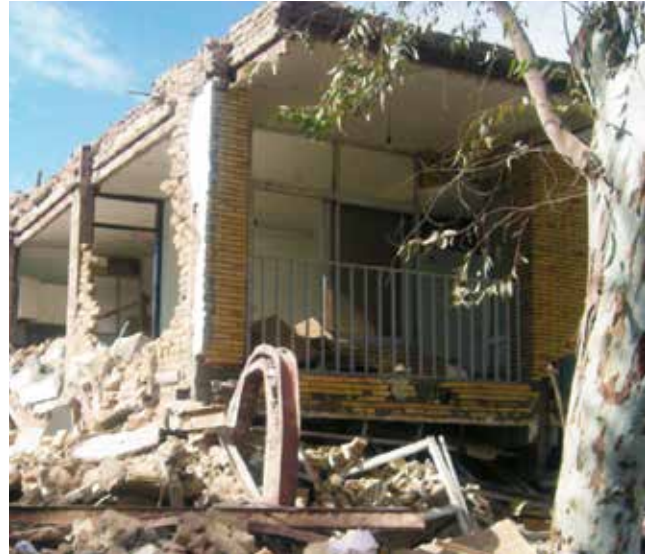
Resim 1: Masif duvarların yıkılma etkisi
