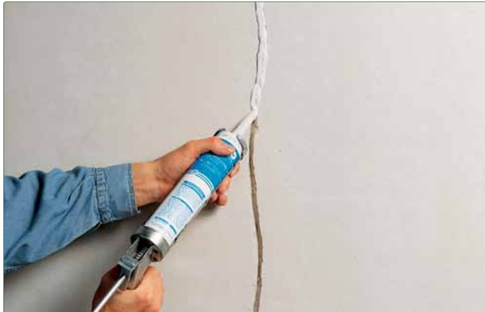
Resim 2: Zarar görmüş alçı plaka duvarın tamirati
